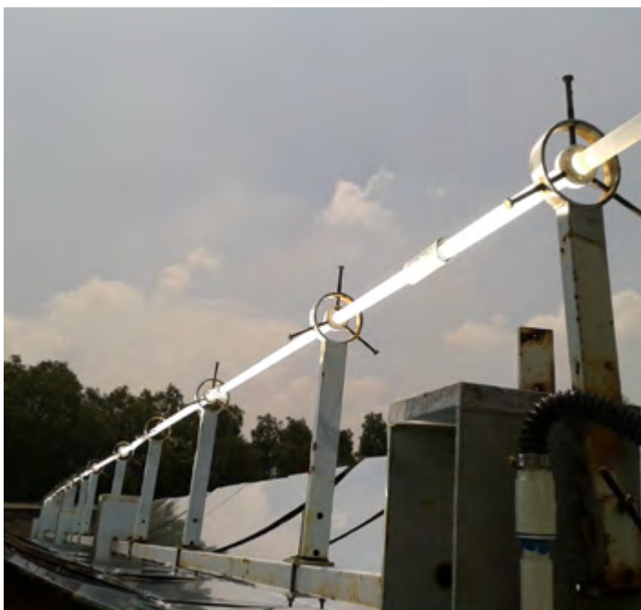
Planta solar del Instituto de Ingeniería de la UNAM.
